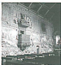
Fot. 5 - A Igreja do Terço, em Barcelos, uma das principais referências da azulejaria nacional, apresenta muitos aspectos da sua composição divorciados do suporte arquitectónico pré-existente
