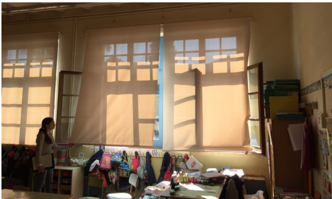
Figura 4 Exemplo de proteção solar ineficaz, pelo interior, obstaculizando a ventilação e a abertura das janelas
